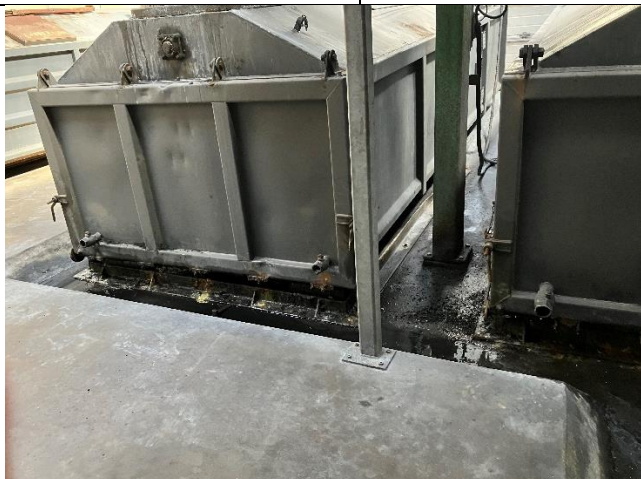
Askecontainere og afløb til lukket system til asken
