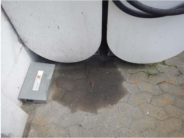
13. Dieseltankanlæg. Spild ses på fliserne lige hvor slangen/pistolhåndtaget hænger.
