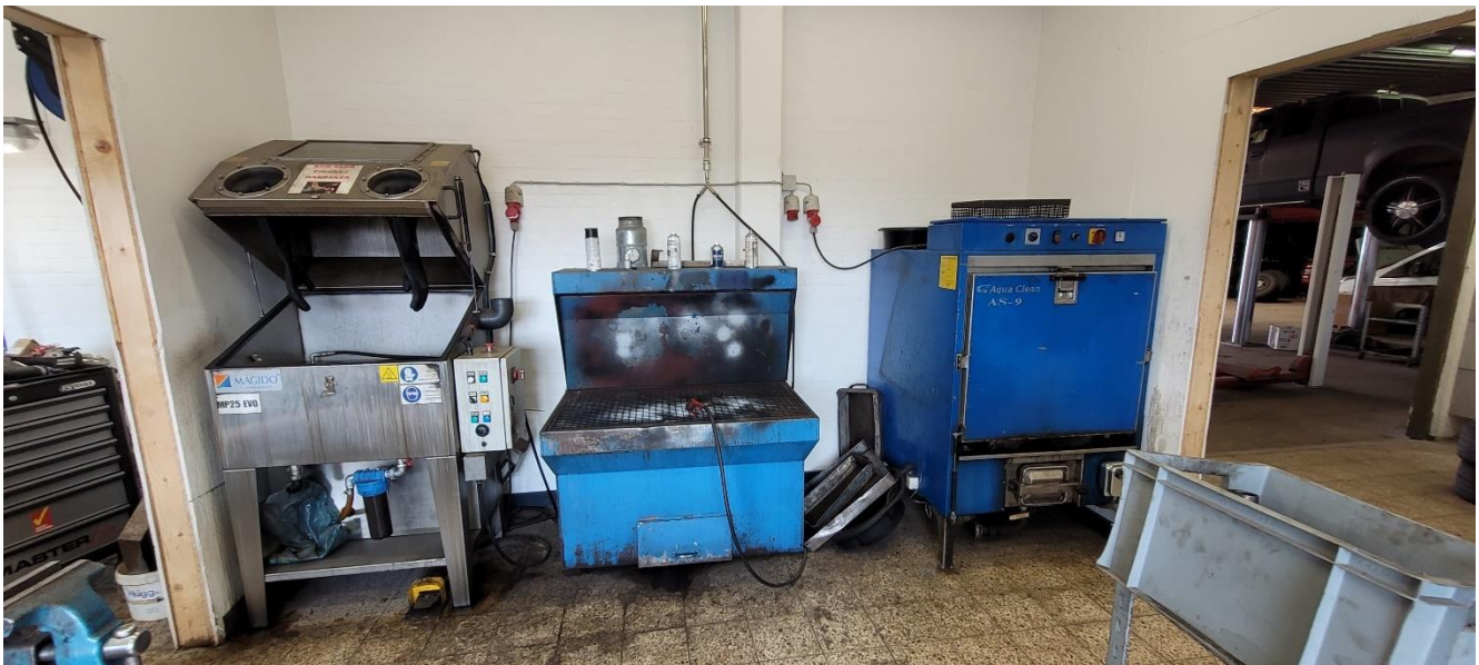
Oliefase fra alkalisk vaskemaskine bortskaffes som farligt affald. Vandfasen genanvendes i maskinen.
