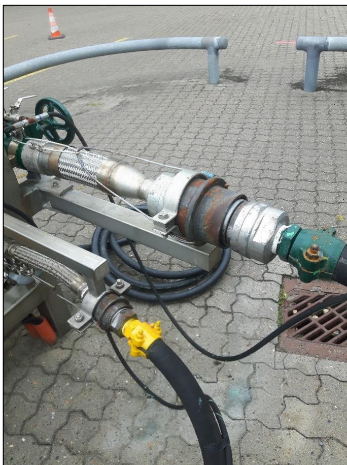
Figur 47 Eksempel på pull away sikring. Foto: WH-PlanAction
