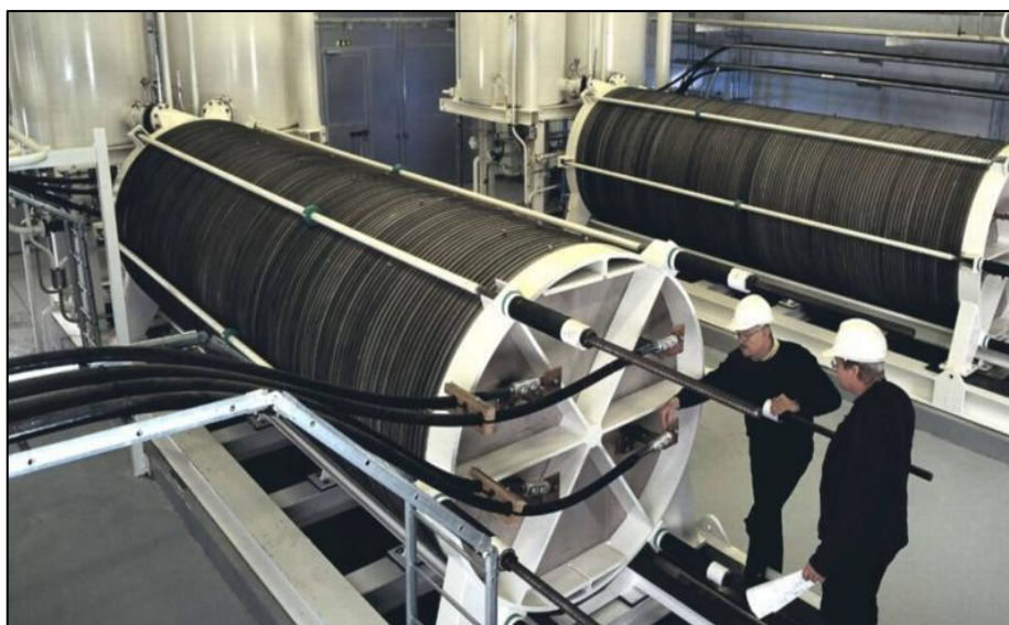
Figur 12 Eksempel på elektrolyseenhed. Kilde: ukendt
