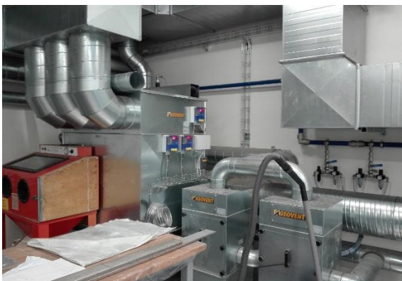
Filter til opsamling af svejserøg og slibestøv i smedeværksted.
