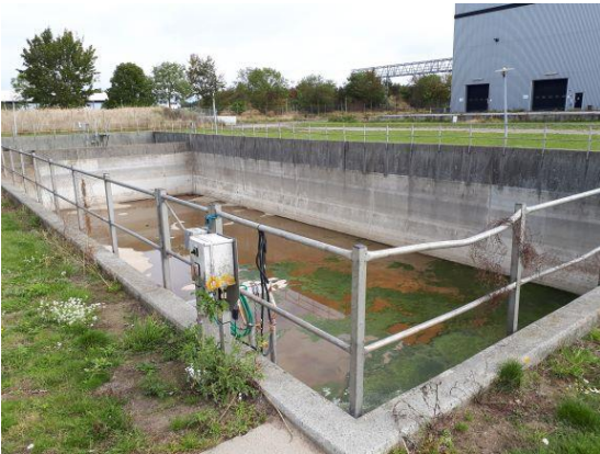
Bassin til regnvandsopsamling. Bassinet har revner og skal renoveres.
