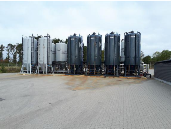
Kulfiltre til efterpolering af spildevand.
