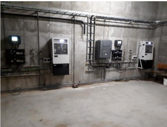
Onlinemålere drift af renseanlæg.
