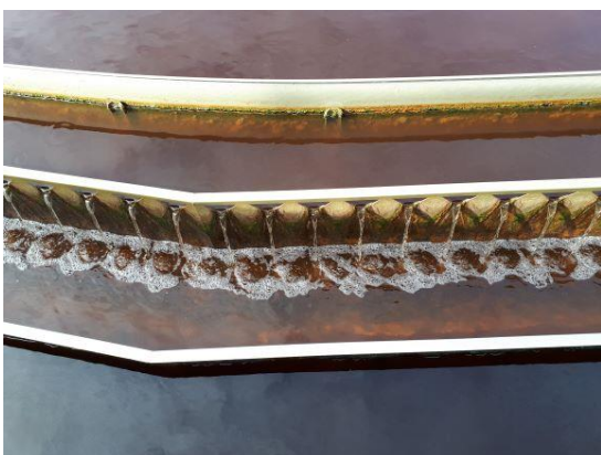
Renset spildevand fra efterklaringstank, men før efterpolering.
