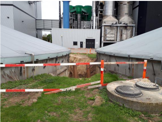
Utæt tank, som er under renovering.
