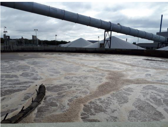
Beluftning nyt anlæg.
