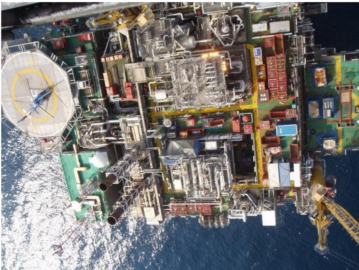
Figur 2 Turbinens skorstene set fra flaretårn, den sydlige skorsten er røggas fra turbinen og den nordlige skorsten er til varmeudledning fra generator enclosure.
