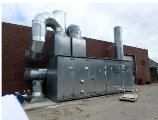
Billede nr. 1: Udsugningsanlæg for maskinværksted mv. samt rumventilation.
