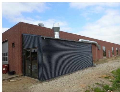
Billede nr. 2: Udsugningsanlægget fra smedeværksted – svejsning og slibning.
