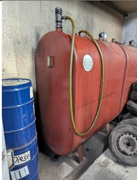
Billede 4. Spildolietanken ved tilsynet i 2025.
