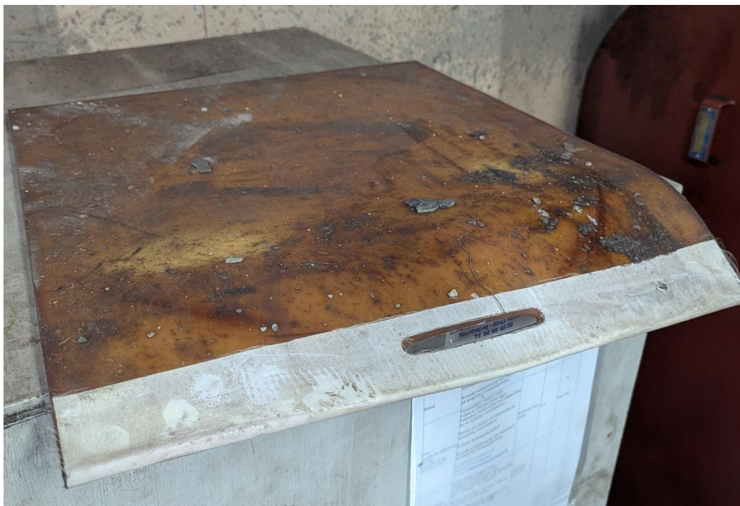
Billede 3. Gummimåtte til sikring af afløb ved uheld. I højre side ses spildolietanken.
