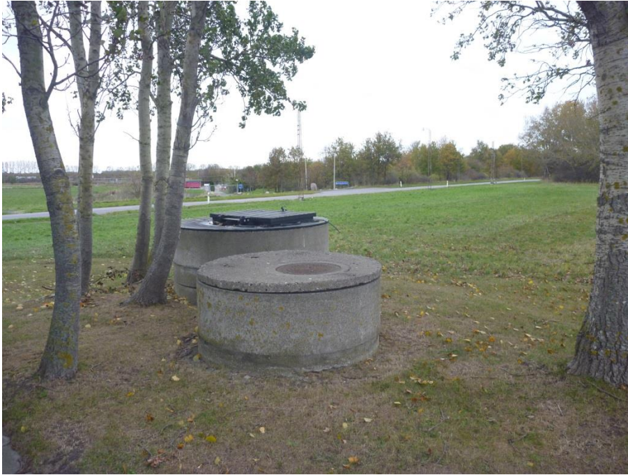
Figur 9. Pumpebrønd (P1- bagerst) for vand fra prøvestation 4
