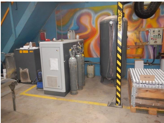
5. Kompresserrum /CO2 anlæg
