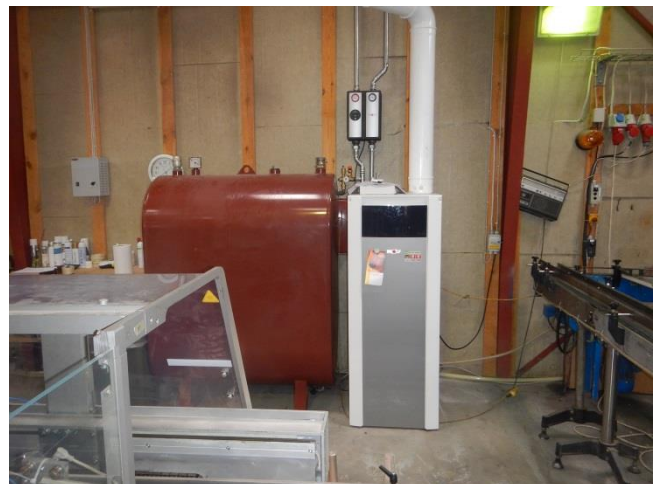
6. Olietank og oliefyr
