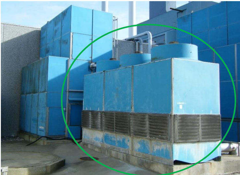
Figur 3. Kilde 12KK1003.00. Ved beregningerne forudsættes støjudsendelsen reduceret/dæmpet. Anlægget er placeret i gårdområdet ved værksted.
