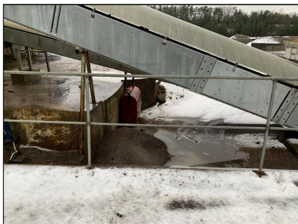
Foto af olietank som bruges til opsamling af spild fra bitumentanke
