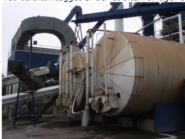
Bitumentanke med isoleret kappe
