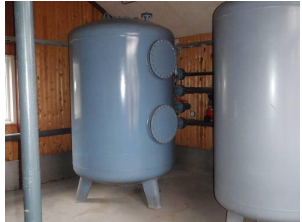
Kulfiltre og til højre ses lidt af sandfilteret
