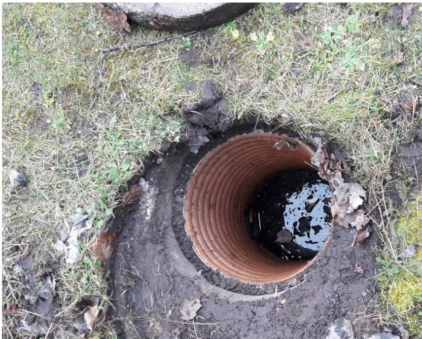
Figur 4: Drænbrønd 15 beliggende i plænen i parken ved Sjællandsbroen.
