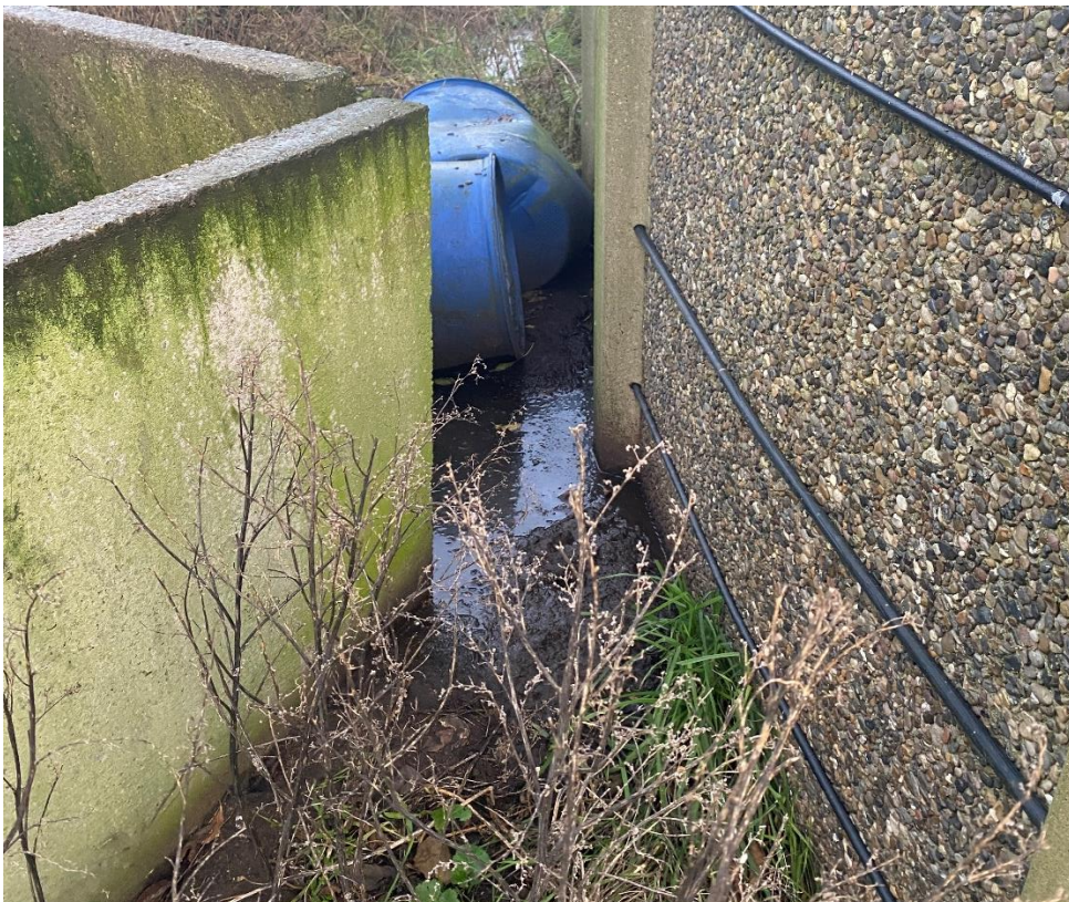
Udløb af væske fra oplagsplads til døde dyr.
