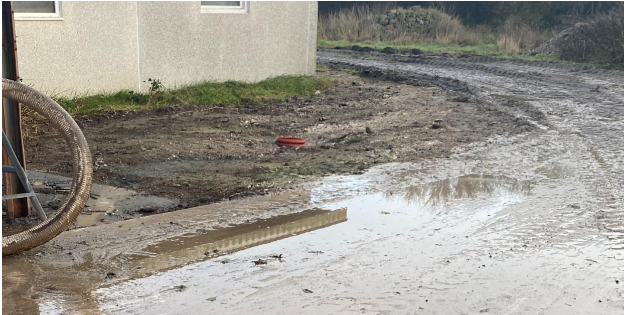
Afløb til vaskeplads, som ikke er etableret endnu.
