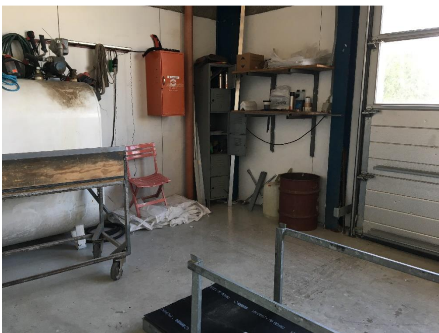
Udleveringsplads for motorbrændstof uden sikring mod, at spild kan afledes via portåbning til det fri
