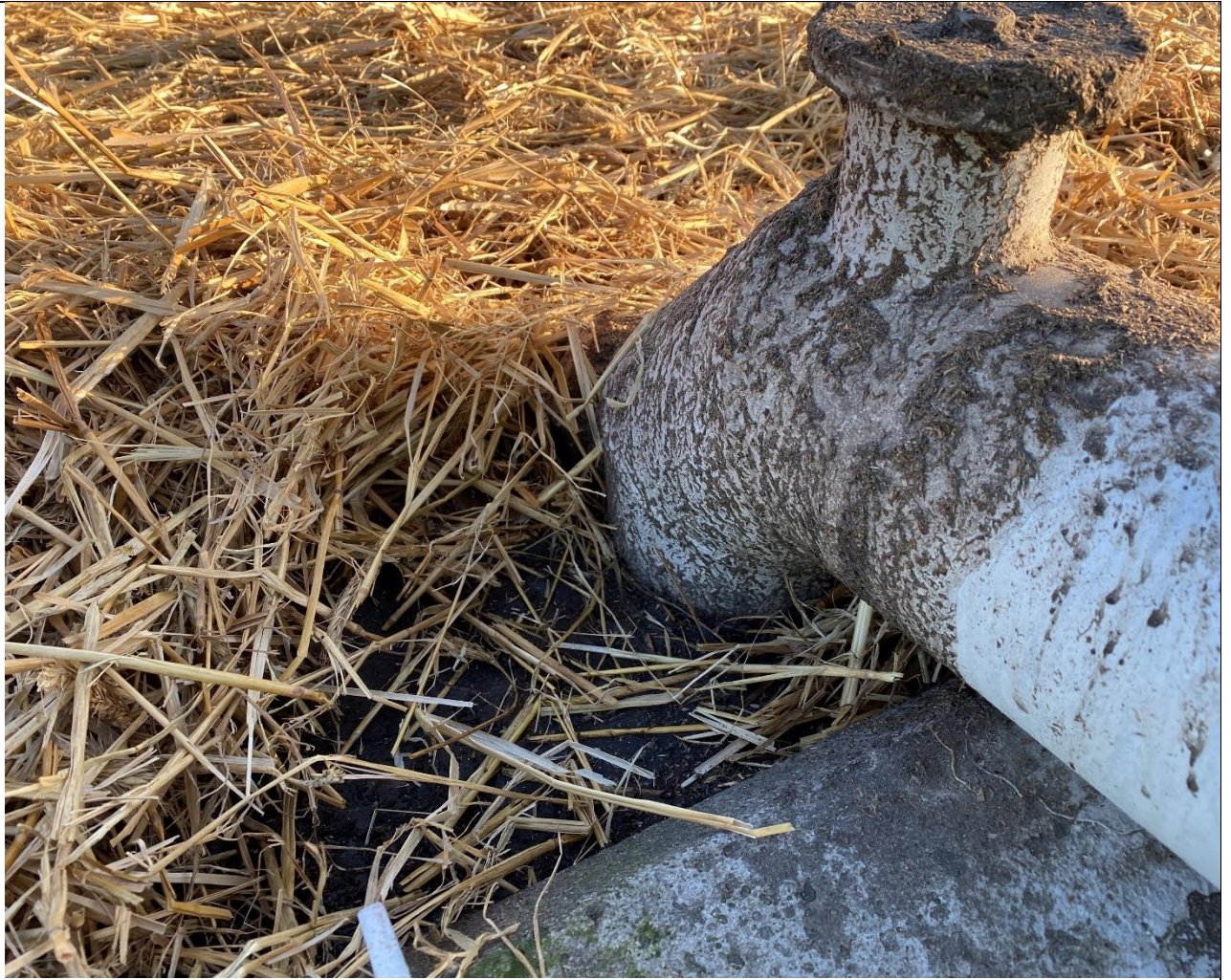
Risiko for overfyldt gyllebeholder?
