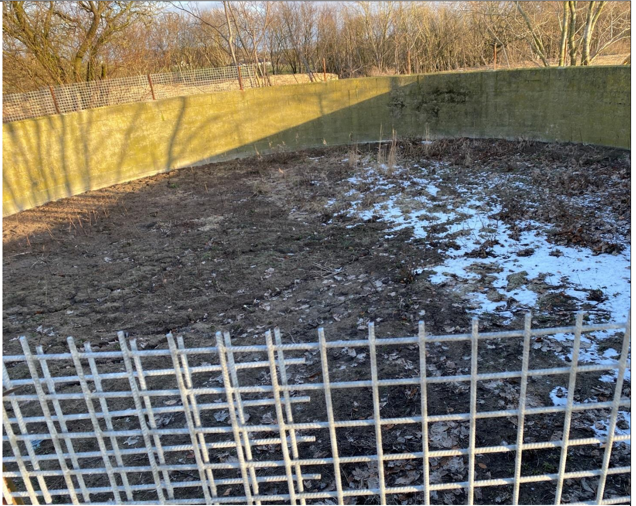
Risiko for overfyldt gyllebeholder?
