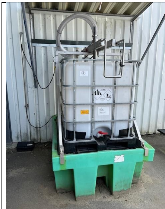
Foto 9 Spildevandstank placeret udendørs under halvtag og på omsamlingsbassin
