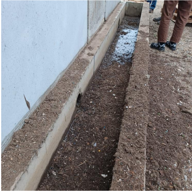
Billede 2: Spildevandsrende på bagsiden af mur mod profuel oplag. På billedet kan det ses at der er spildt materiale ud over jorden og i spildevandsrenden.
