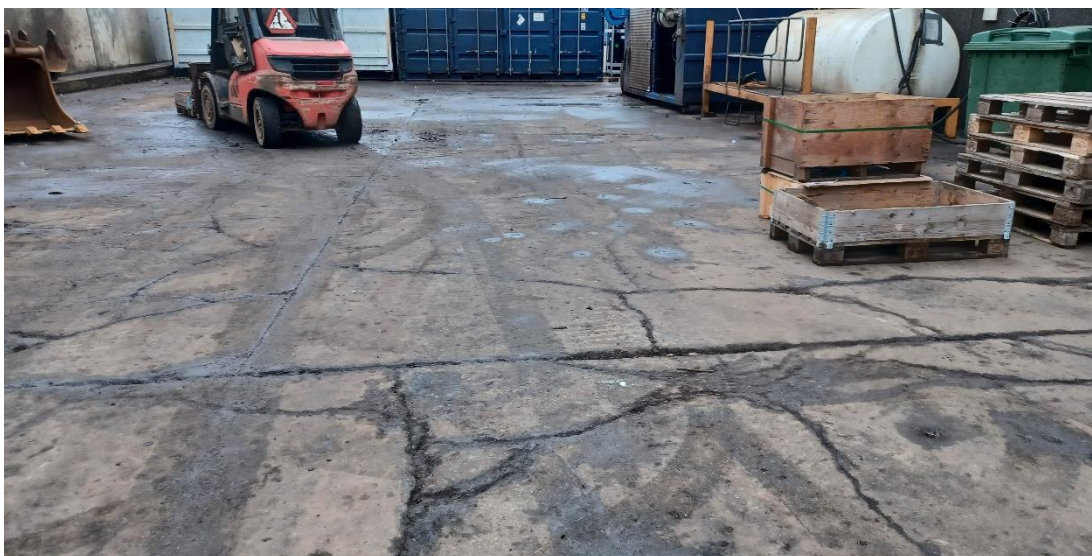
Billede 1: Betondæk ved værksted og olieudskiller
