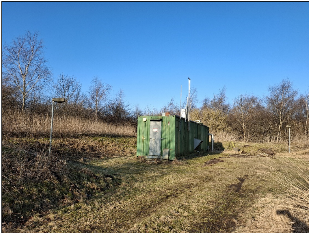
Foto 7: Container indeholdende gasindvindingsanlæg.
