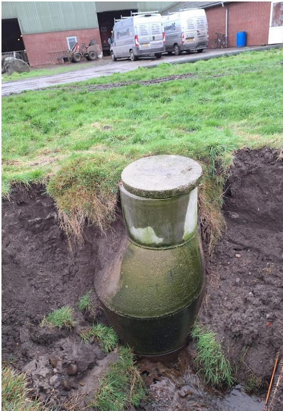
Figur 10. Forurening med lammehaler nær brønd.
