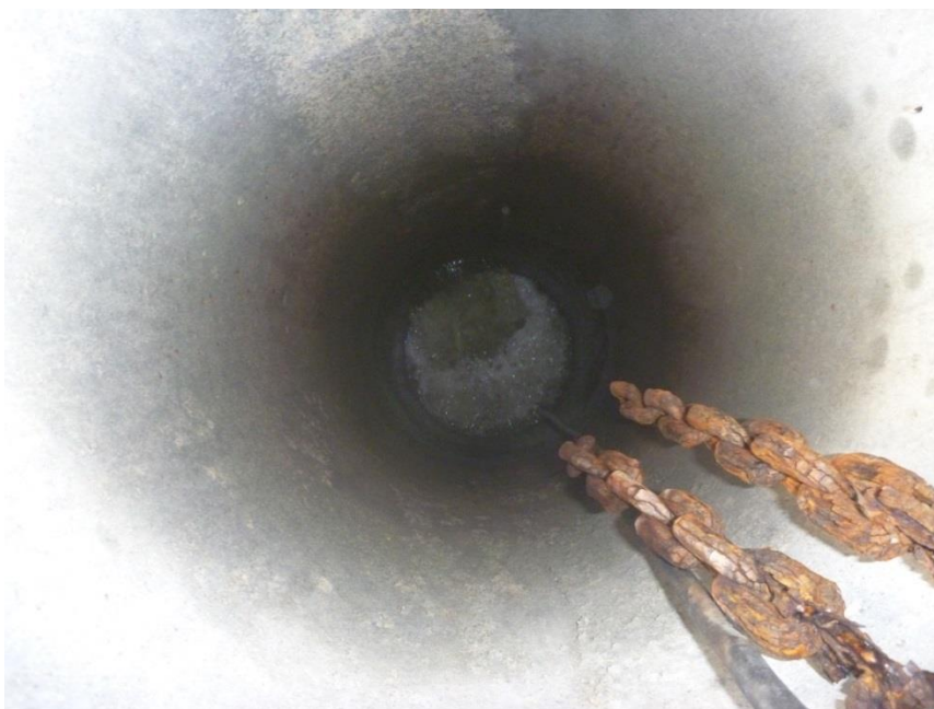
Ovenstående billede viser pumpebrønden, som er beliggende på deponiet mellem samlebrønden og udløbet til Svanholmgrøften. Af billedet fremgår, at der løber vand retur til pumpebrønden fra Svanholmgrøften. Dette skyldes en defekt kontraklap, som gjorde, at vand løb tilbage til brønden igen efter endt udpumpning af perkolat til åen. COWI oplyste, at Aalborg Kloak A/S muligvis ønsker at benytte et nyt prøvetagningssted for perkolat, som derfor blev drøftet ved tilsynet.
