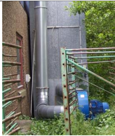
Ventilator for udsugning fra pudsesektionen
