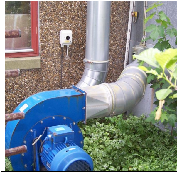
Udsugningsventilator fra pudsesektionen
