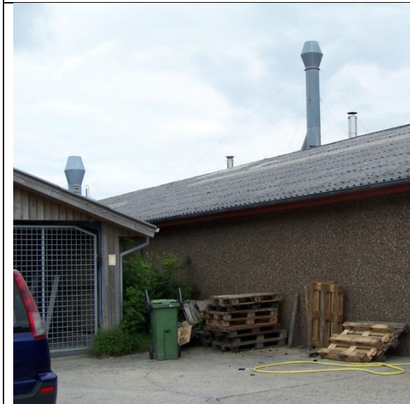
Afkast for sprøjtning med vandbaseret maling tv. Afkast for sprøjtning med syrehærdende lakker th. 2 afkast (de mindste) for oliefyringsanlæg
