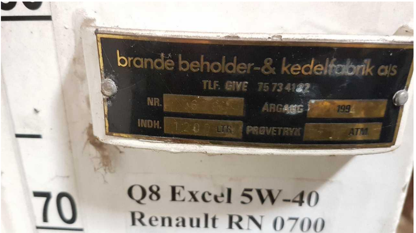
Tankplade på olietank til oliefyr.
