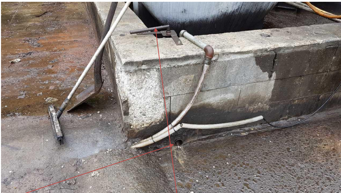
Afløb (hul gennem væg) og tankgårdsventil (stangen øverst på muren)
