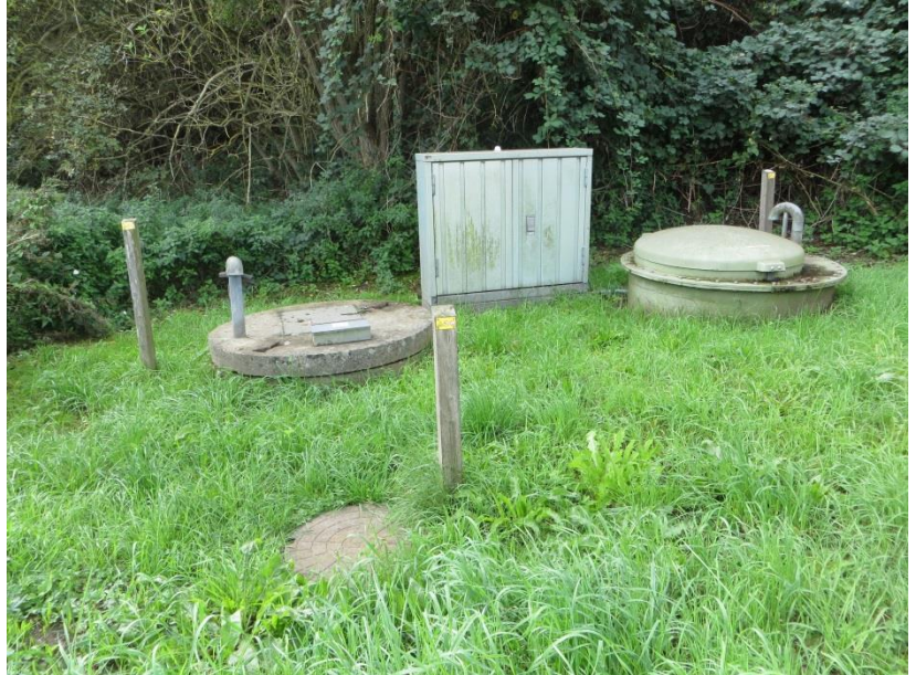
Foto 1 Central pumpstation P1 for overfladevand og perkolat til rensningsanlæg
