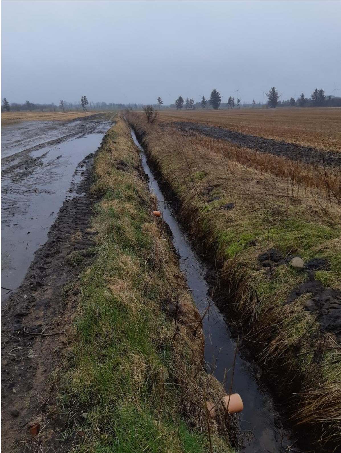
Foto af skelgrøft mellem 27p og 27x, 17. marts 2023. Dage forinden har været præget af store nedbørsmængder og jorden er vandmættet. De orange drænrør er afløb for overfladevand fra det bestående anlæg. Ved en ny besigtigelse den 12. april 2023 er det konstateret, at der ikke er betydende vand i grøften. Det konstateres samtidig, at grøften ikke har synlige tilløb fra vest eller synlige afløb mod øst. Grøften vurderes heraf ikke at være vandførende, og betragtes ikke som et vandløb i Vandløbslovens forstand.
