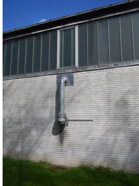
2. Afkast af udsugningsluft fra svejse-/slibarbejdsplads (via filter) ført ud gennem væg og nedadrettet
