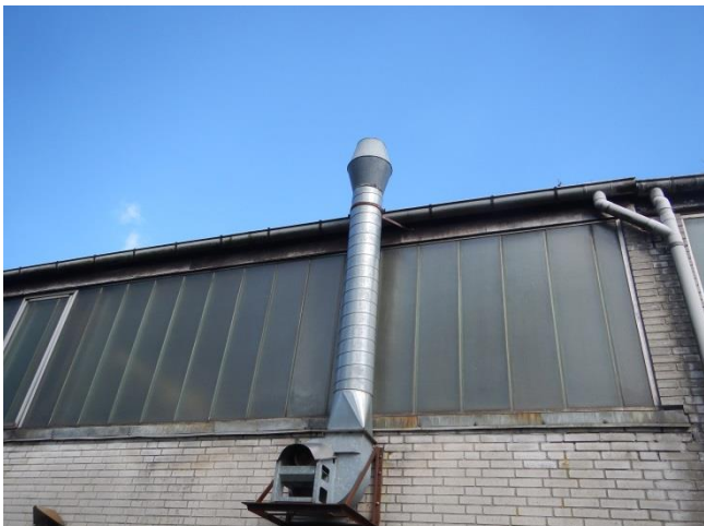
3. Afkast af udsugningsluft fra svejse-/slibarbejdsplads er (via filter) ført 1 m over tag
