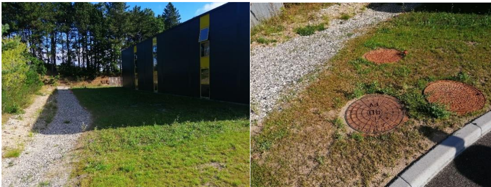
Billede 2 Olieudskilleranlæg ved nedgravet rørsystem (underjordisk forsinkelsesbassin til overfladevand).
