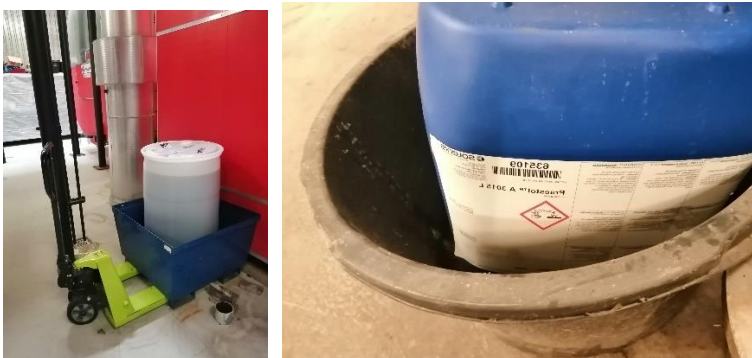
Billede 3. Oplag af kedelstenvæske og præstol til afvanding på båndfilter
