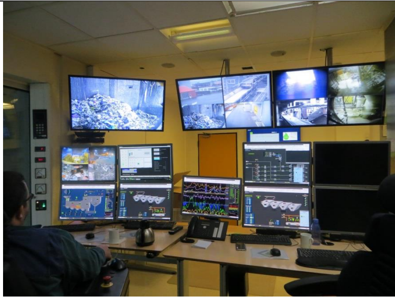
Kran- og kontrolrum med SRO overvågning
