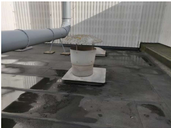
12. Udluftning fra fabrik afkast 4
