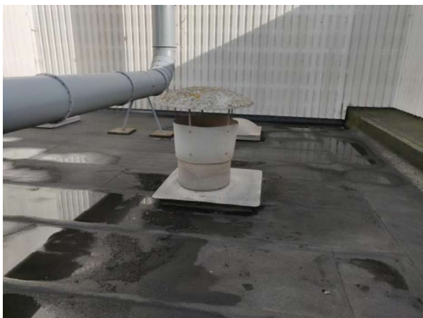
12. Udluftning fra fabrik afkast 4
