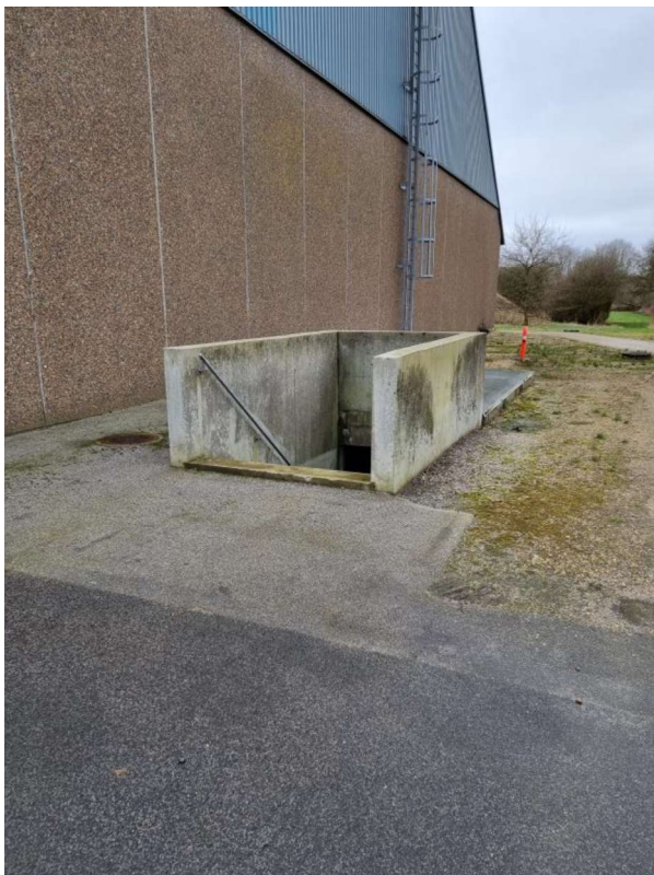
8. Indtag til beluftning hal 2002
