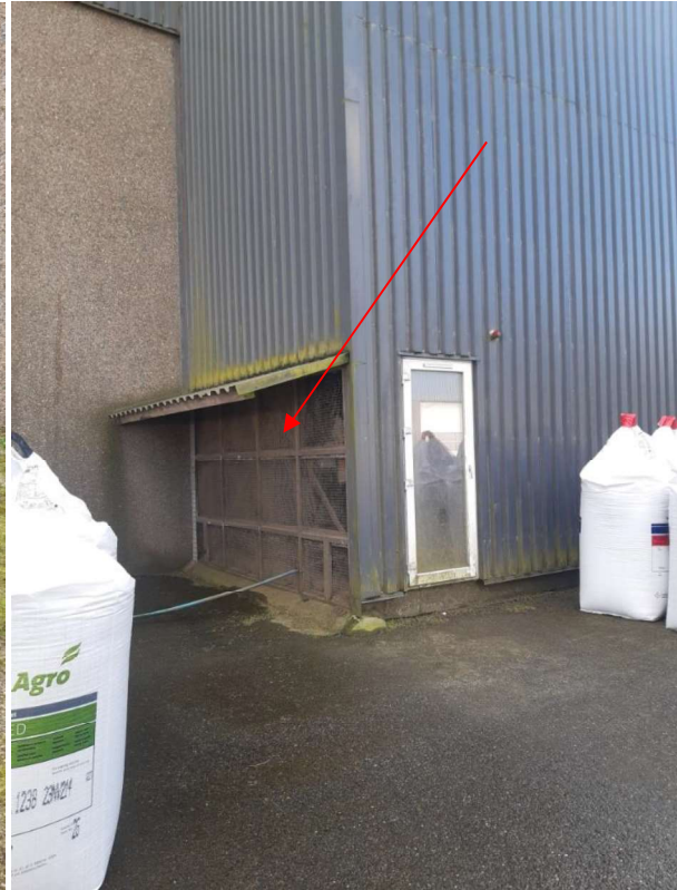
7. Indtag nord til beluftning hal 2007
