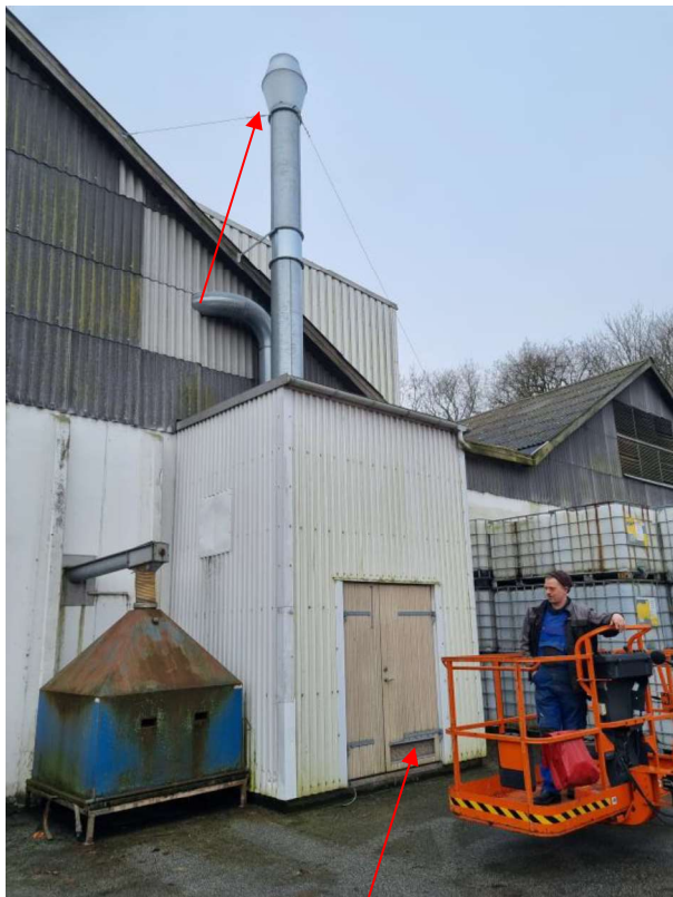
1. Filterafkast til opsækning 2. Luftindtag, ventilation til opsækning
