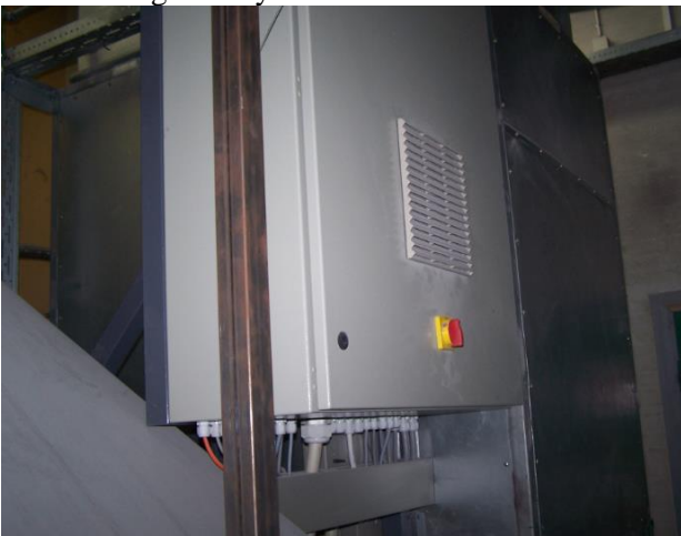
Anlæg til ”brænding” af indsugningsluft til sprøjtekabinerne
