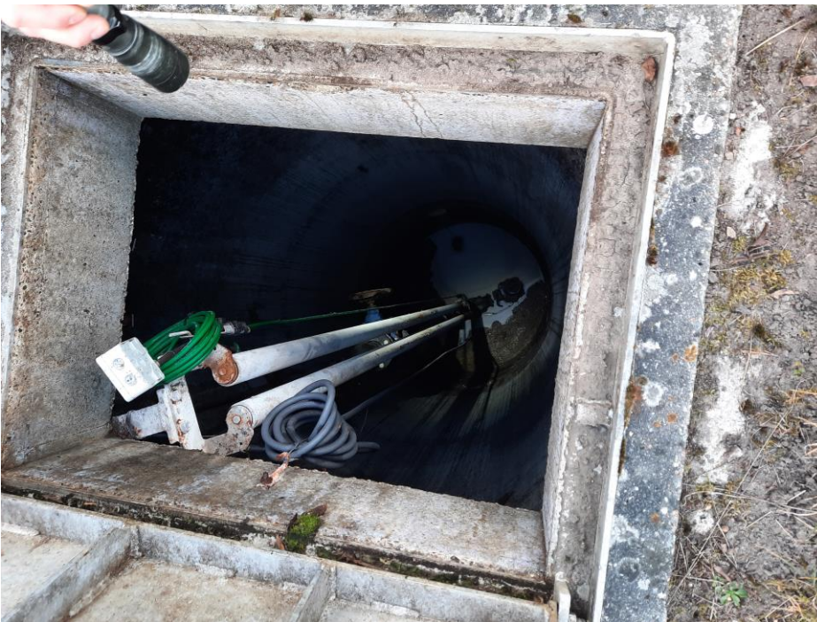
Billede 2: Afløb udenfor med pumpesystem
