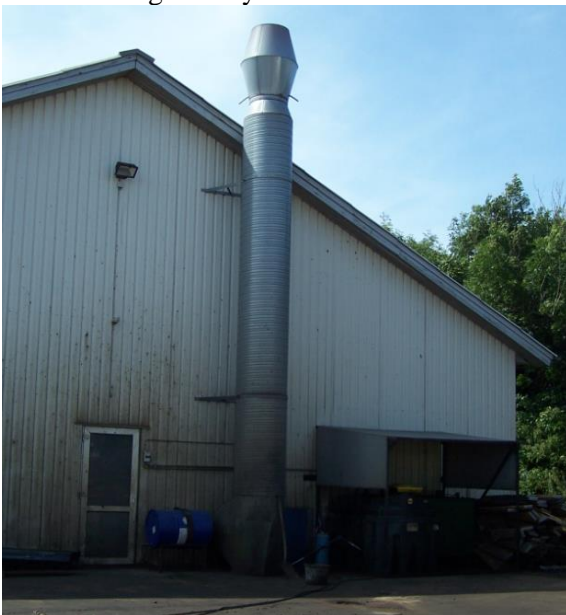
Spildolietank og fyrings- og gasolietanke under tag i 2014 – nederst til højre
