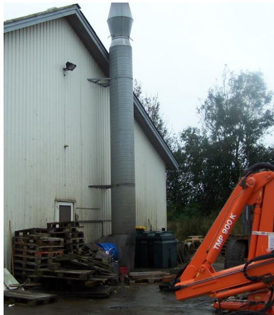
Spildolietank og fyrings- og gasolietanke uden tag i 2011 (se nederst til højre)
