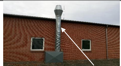
Billede nr. 4: Afkast fra rumventilation i slibehal
