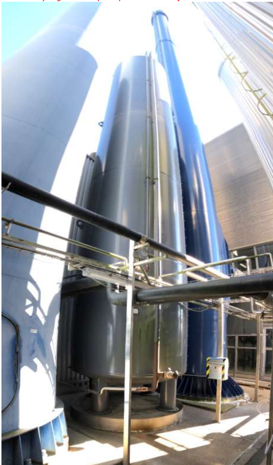
Fyringsolietanken står på impermeabel overflade, betondæk.
