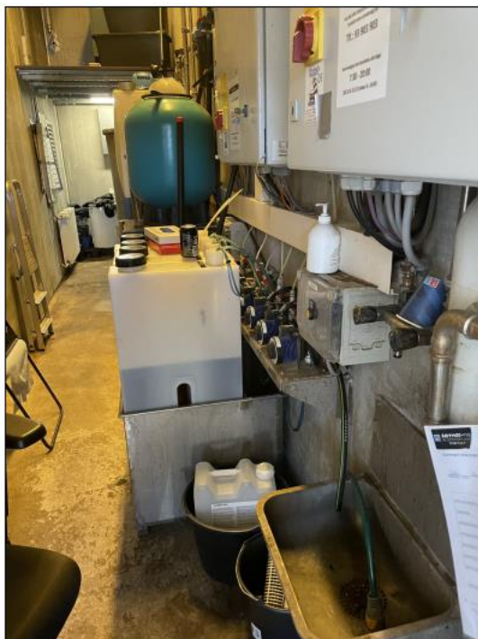
Billede 2. Teknikrum til vaskehallerne
