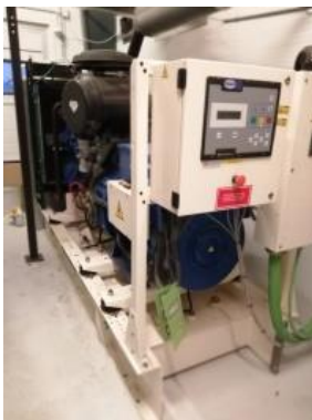
Billede nr. 4: Nødstrømsanlæg (2019)
