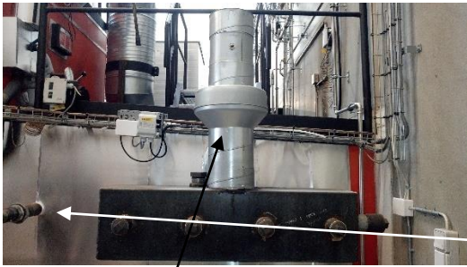
Billede nr. 2: Blæser til sikring af tilstrækkelig luft ifm. nedlukning af kedlen (2022)
