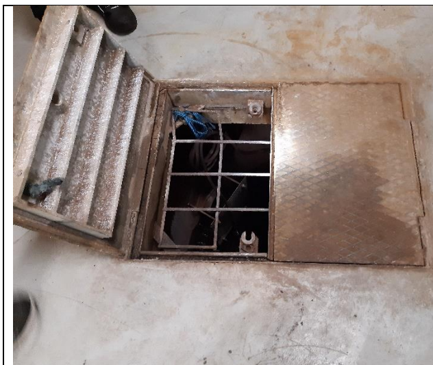
Foto 7: Afløb fra rummet hvor skumtanken står.
