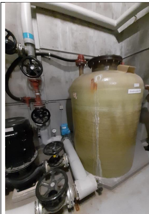
Foto 4: Skumtank koblet til vandrør.
