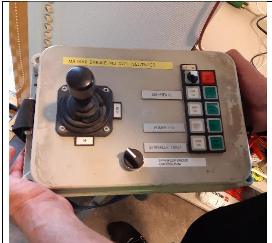
Foto 3: Betjeningspanel i kontrolrummet, til betjening af brandslukningsanlæg.
