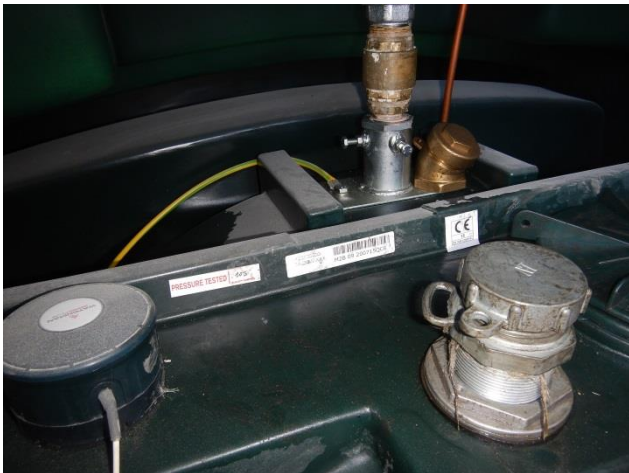
13. CE mærket tankanlæg. Påfyldningsstuds bag aflåselig låge.
