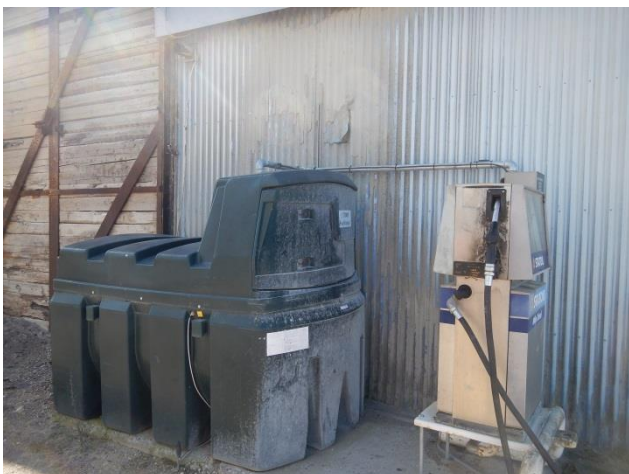
9. Dieseltankanlæg 2500 l, plast , opstillet 2015. Tank og stander står på befæstet betonplads.
