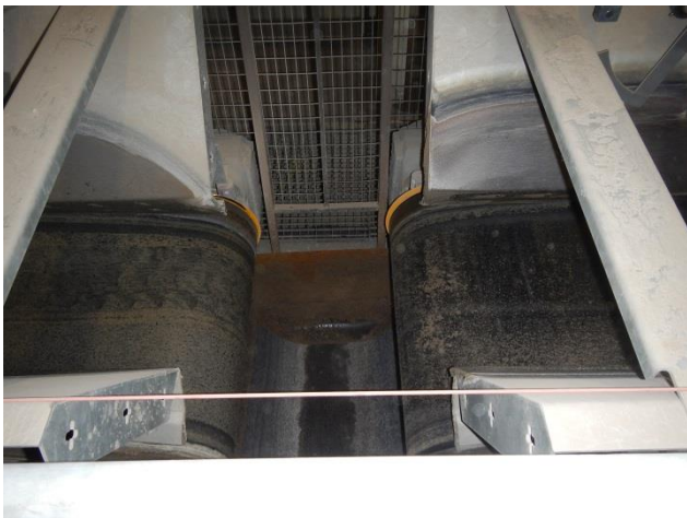
21. Transportbånd der fører afvejede mængder af tilslag til blandedanlæg
