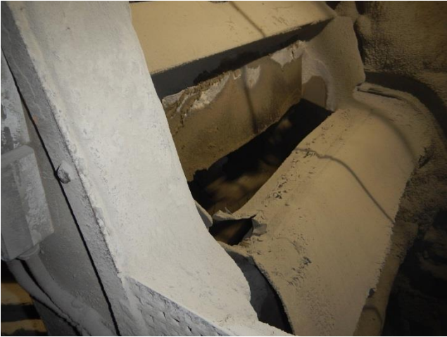
31. Skakt for færdigblandet beton til udlevering- se foto 15.
