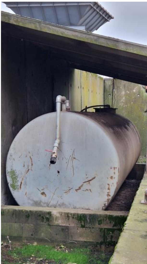
Spildolietank med køle-/smøremiddel står i tankgård, som ikke formodes at kunne rumme indholdet af tanken ifm. spild.
