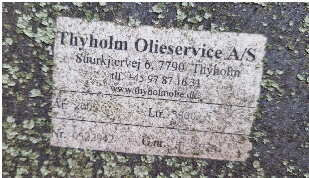
Tankplade på dieselolietank.
