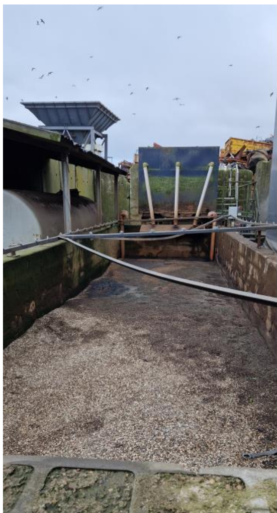
Sten-/sandfilter ifm. intern spildevandsrensning.
