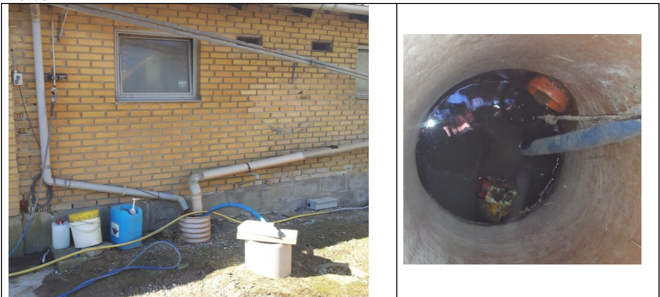
Sikkerhedsanordning: Overfladevand, som løber til afløbsrist (nederst højre hjørne af foto 1) nær fortank og ældste gyllebeholder, er styret af on/off knap. Knap skal være aktiveret, for at der pumpes til dræn. Dette er en nyttig sikkerhedsanordning. Tagvand ledes direkte til dræn.
