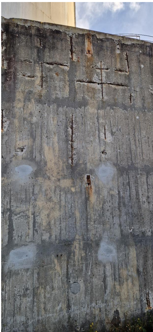
Tankgård 1. Ringmuren set udefra – der er betonaufskalninger og synligt armeringsjern på det meste af ringmurens yderside.
