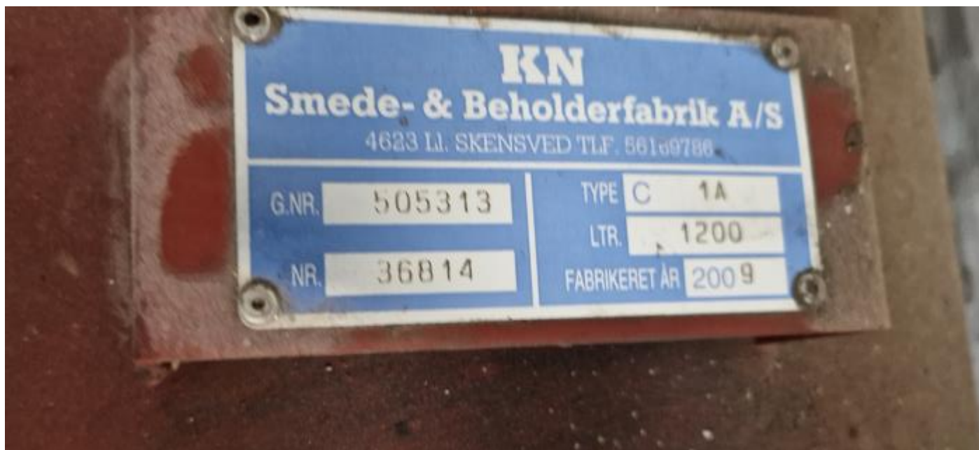
Tankplade på fyringsolietank.
