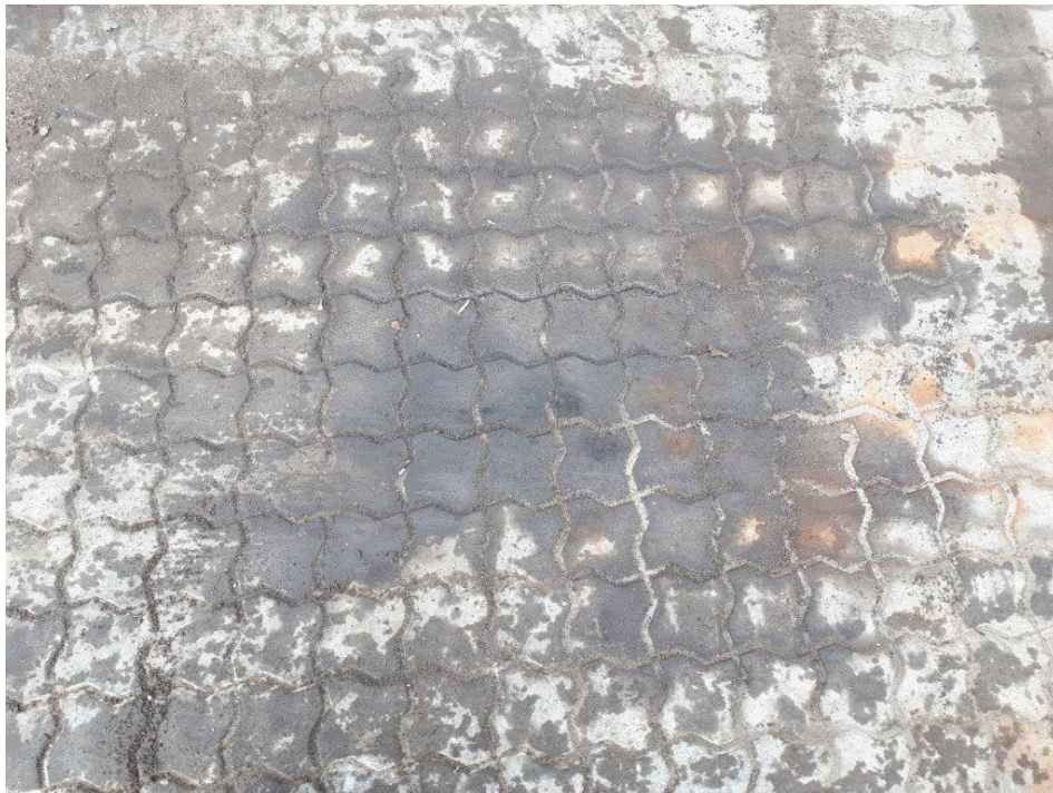
Spild af olie på den ikke tætte belægning.
