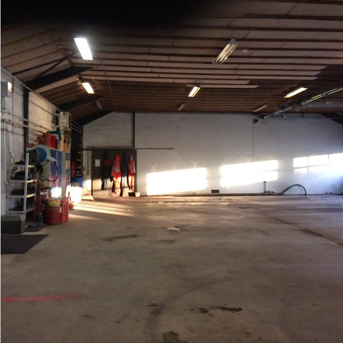
Billede 11 Garage uden afløb
