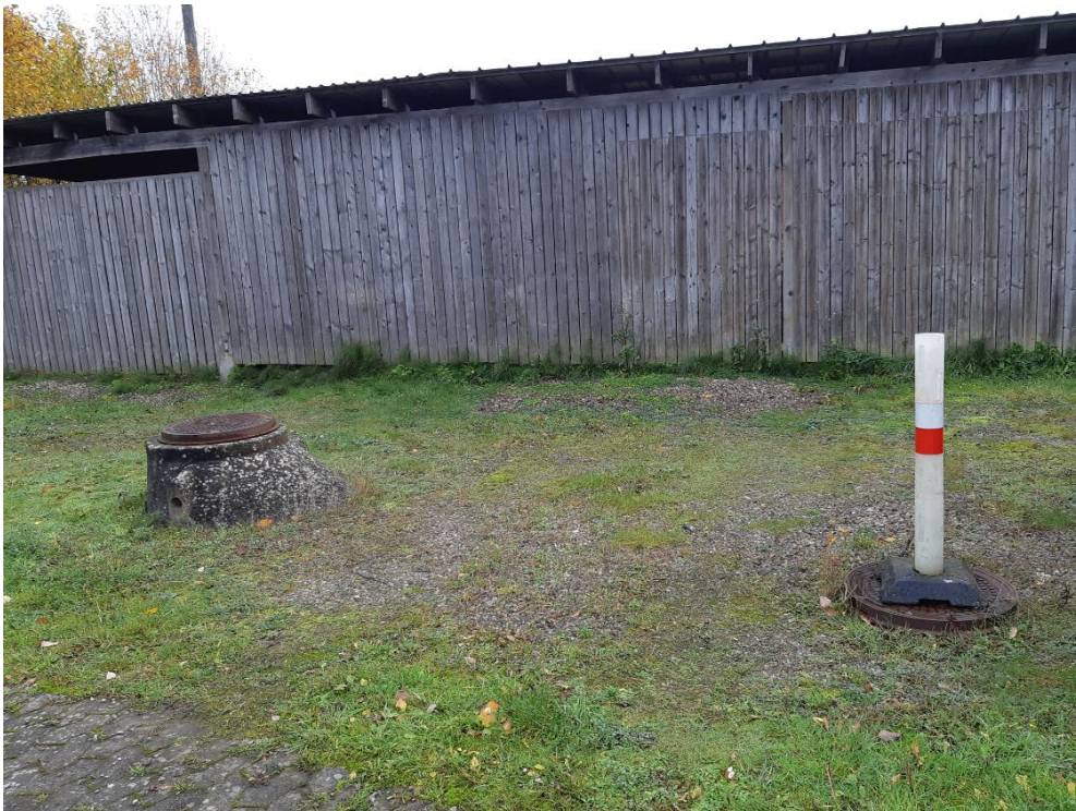
Brønde i forbindelse med olieudskiller
