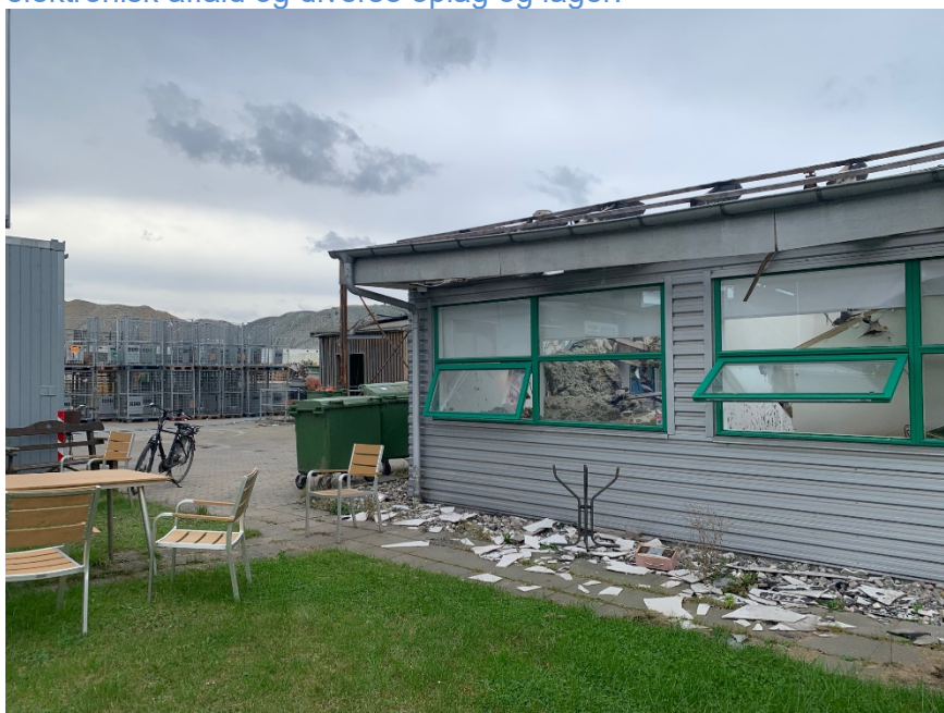
Figur 1 Til venstre for den brændte bygning, ses lidt af en modul/kontor container, som er stillet op i 2 plan
