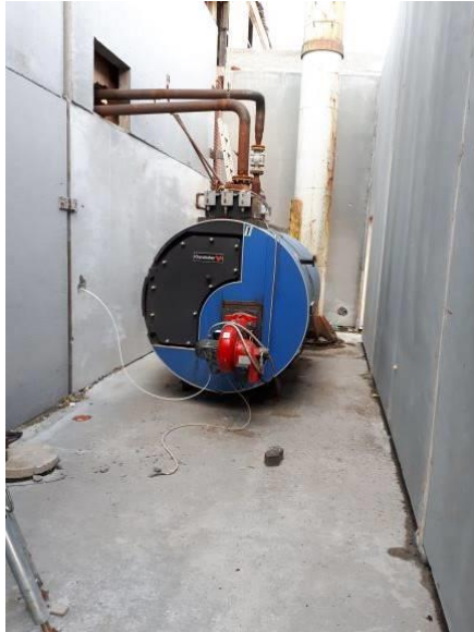
Eksisterende oliefyr som skal nedlægges.
