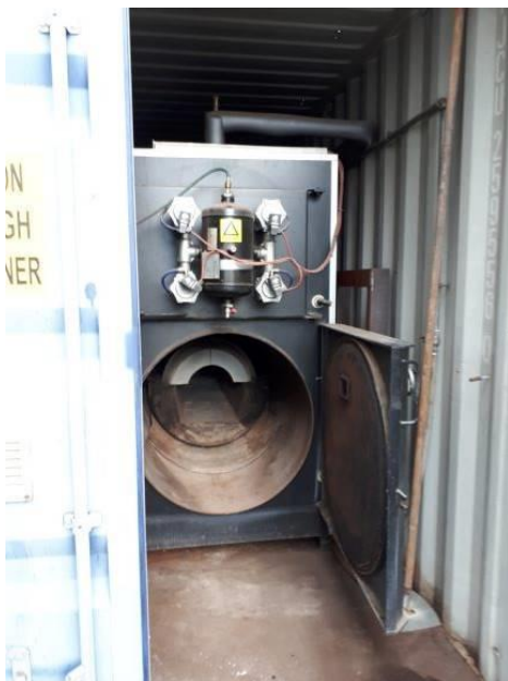
Pillefyr, som bl.a. skal erstatte oliefyr. Der installeres også gas.
