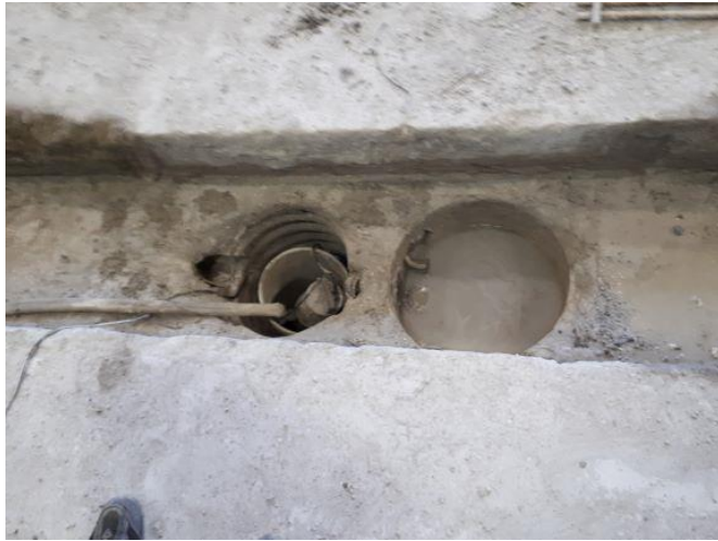
Afledning af spildevand fra produktionshal med pumpe.
