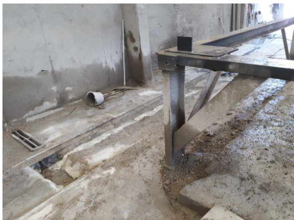
Afløb fra vaskeplads
