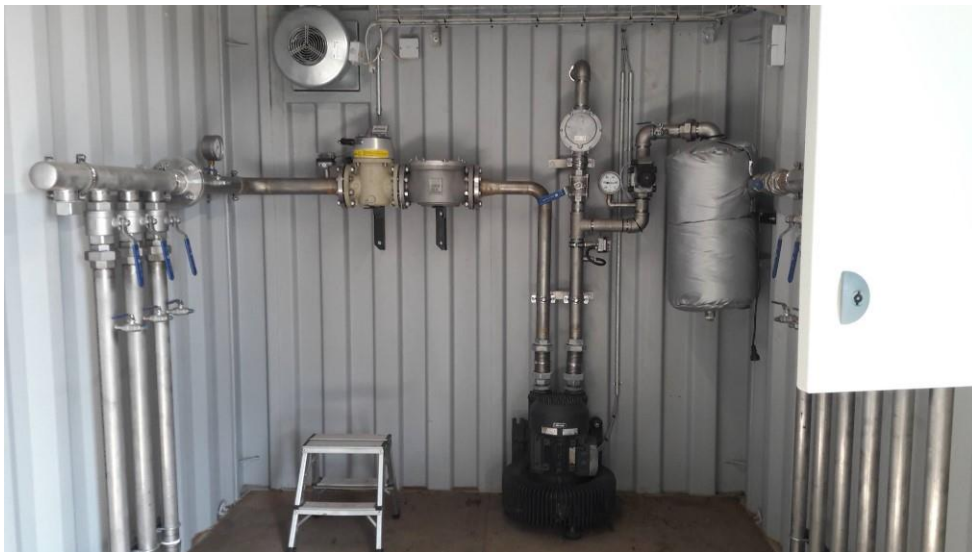
Gashuset, hvor styreskab (bag den hvide låge) og indgangsrør ses til højre, gaspumpe, der dels suger gas til og dels pumper det videre til biocover-filteranlæg (kompostbede) med iblandet atmosfærisk luft fra indtag over pumpe ses i midten, til venstre ses de 3 udpumpningsrør til kompostbedene.
