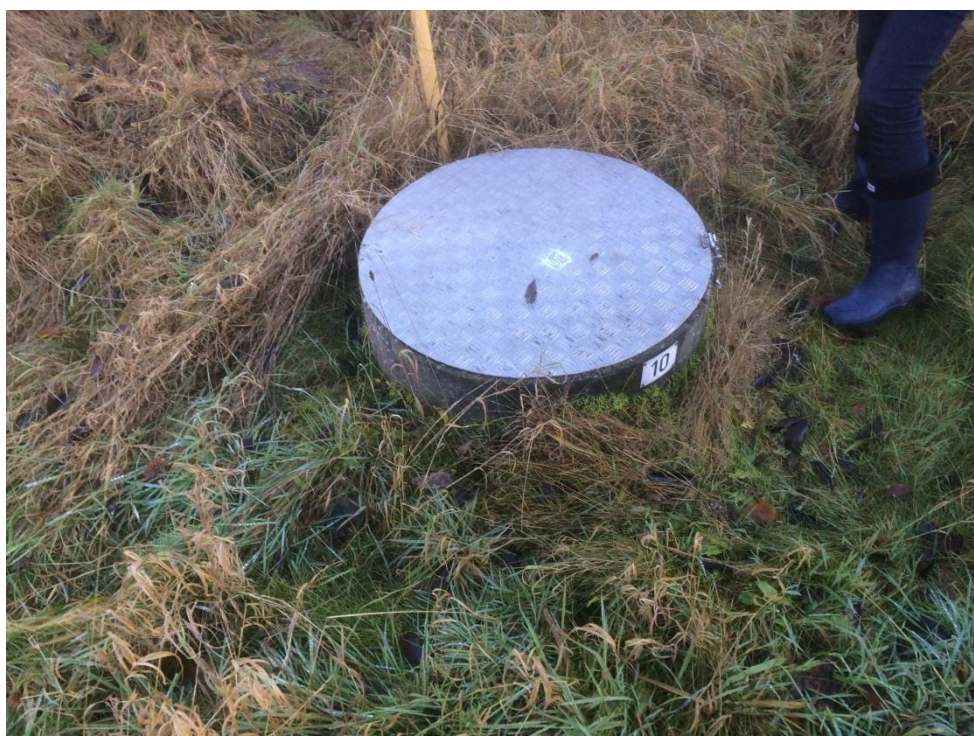
Brønd B10, hvor overfladevand fra indkørslen opsamles.
