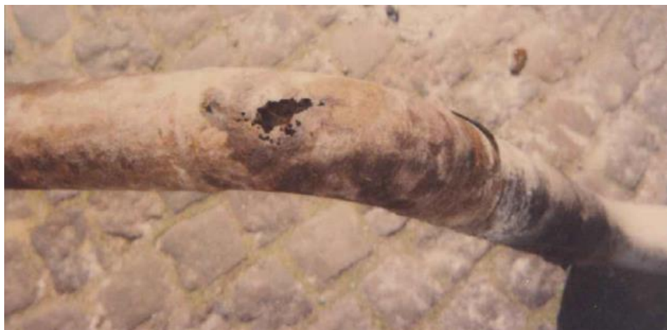
Figur 7 Foto fra 1990 af utæt rør, tank 18.
